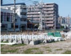
連続立体交差事業西鉄天神大牟田線(春日原~下大利) 約3.4km 平成26年度完成を目指しています。
